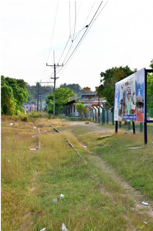
Illustration 4 : section de voie ferrée sans entretien et recouverte de végétation
