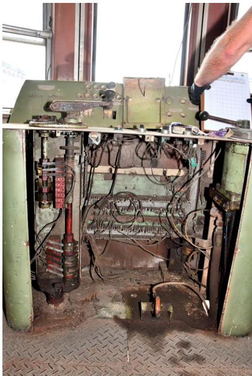
Illustration 17 : état du câblage sous les postes de conduite
