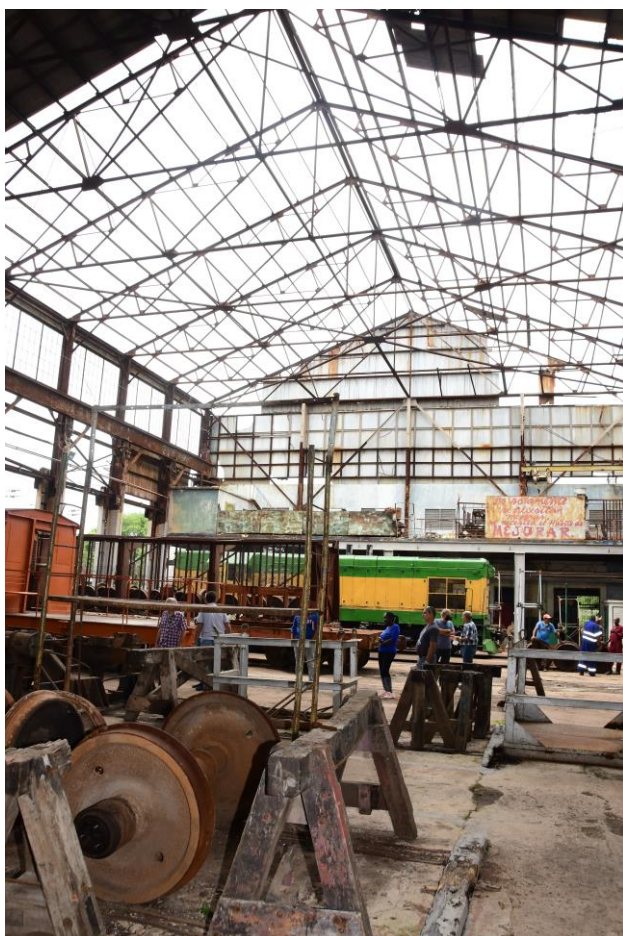
Illustration 2 : vue de l'intérieur du dépôt-atelier de Hershey. La toiture n'existe tout simplement plus, donc les conditions de travail sont très difficiles
