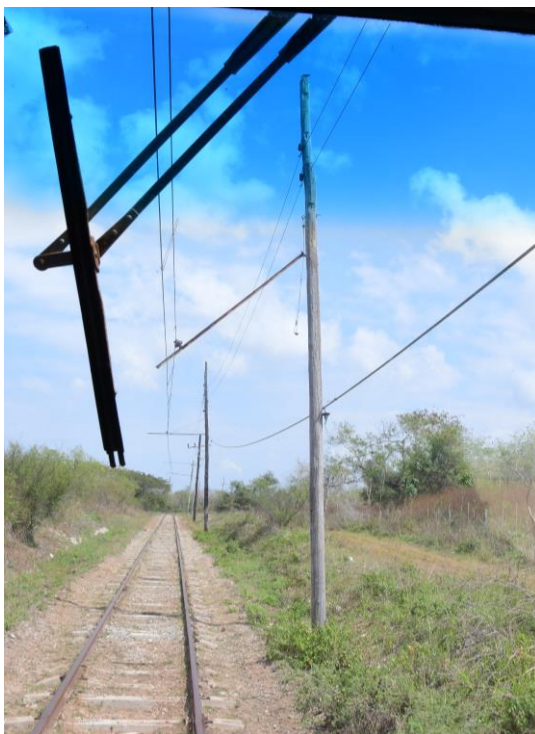
Illustration 5 : exemple d'usure des supports de ligne aérienne, avec ici une barre de soutien horizontale afaissée interrompant la circulation des trains électriques
